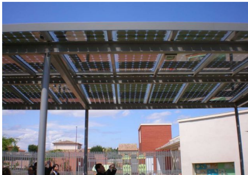
※ 渡り廊下の太陽光パネル設置状況
